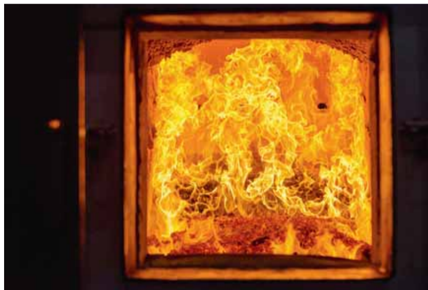
Nur Holz aus der Region wird in Form von Holzschnitzeln verbrannt. Der hier abgebildete Sommerofen wird automatisch mit Brennstoff versorgt.
