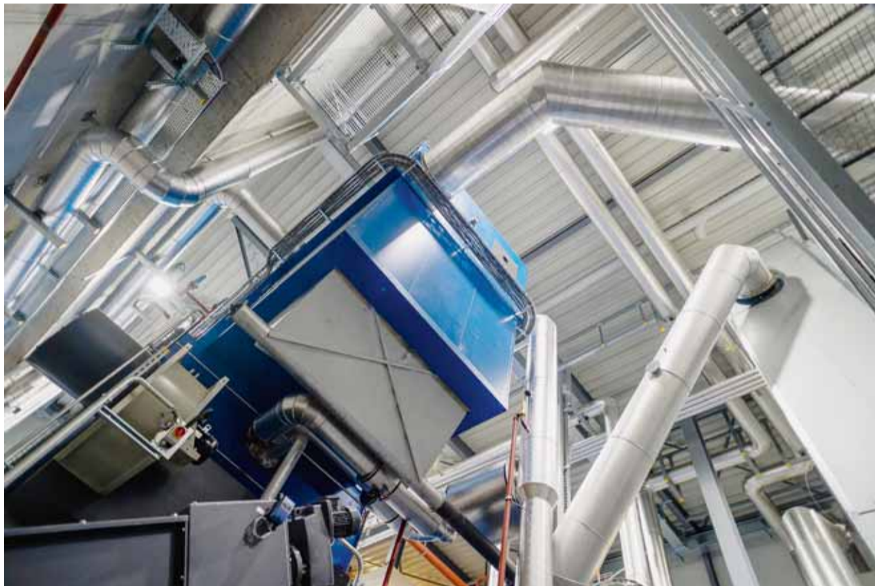
Der riesige Winterofen des Wärmeverbunds Biel Battenberg ist im Moment ausser Betrieb. Die Anlage ist acht Meter hoch, hat ein Gewicht von 30 Tonnen und erzeugt eine Leistung von 3200 Kilowatt. Bilder: Matthias Käser
